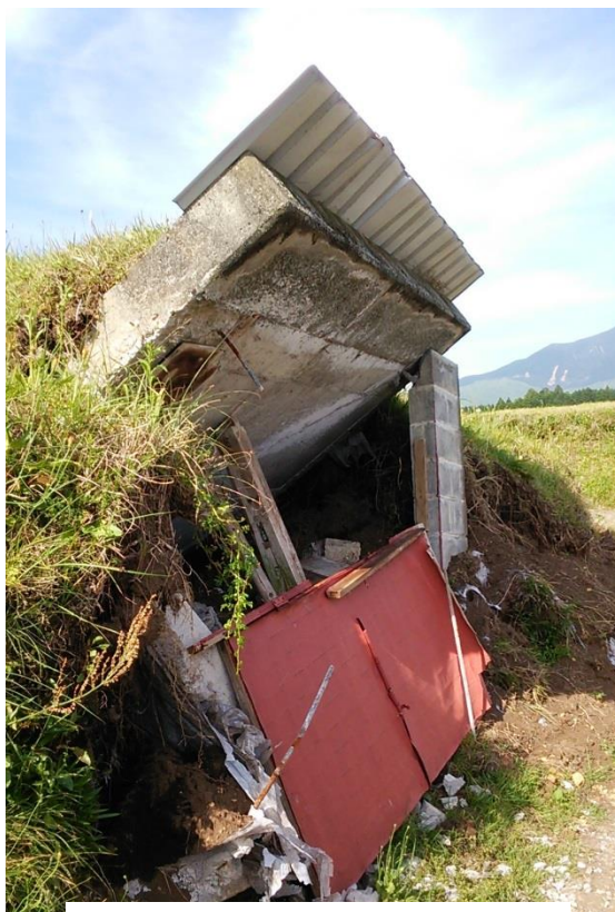
倒壊した貯蔵庫
